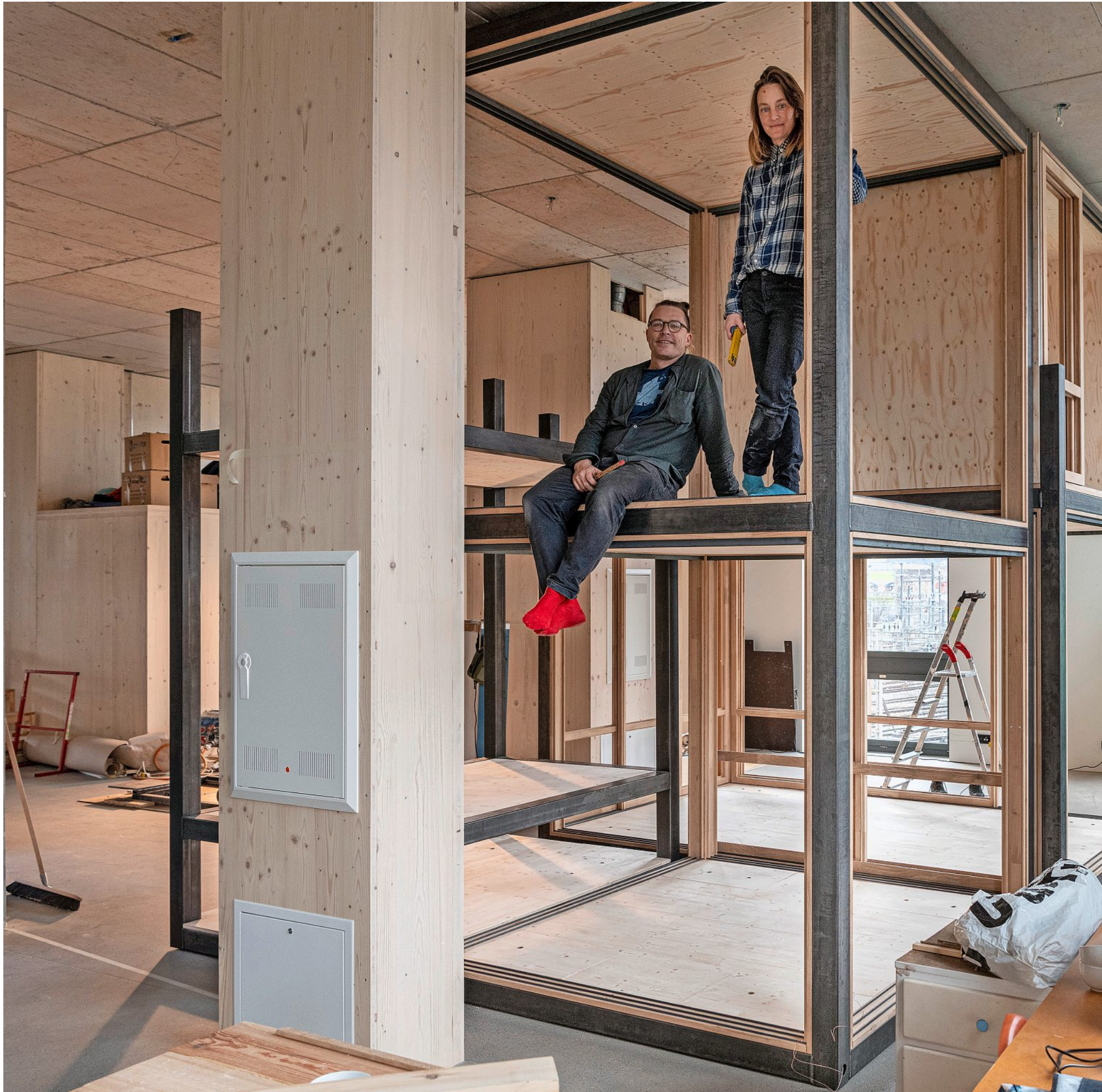
Halle XL: In Wohntürmen mit zwei Etagen werden Mätti Wüthrich und Eva Maria Küpfer künftig zusammen mit ihren Kindern wohnen. Fotos: Urs Jaudas
